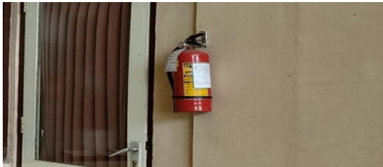
Gambar 11. Penyediaan APAR di Bengkel Batu dan Beton SMK N 2 Pengasih
